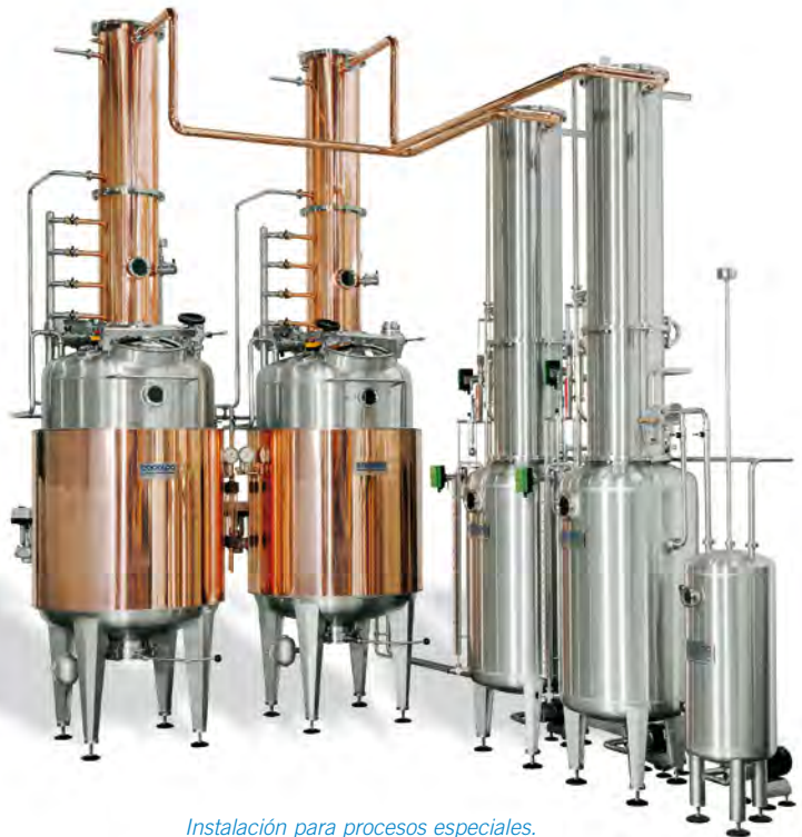
Instalación para procesos especiales.
